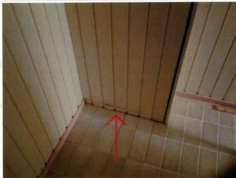
Kodinhoituhuoneen seinä paneelien alareunassa on tummentumaa jalkalistoja alla
